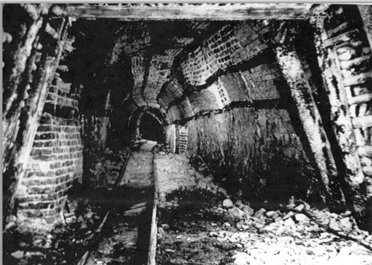
Abbildung 20 Durch Gebirgsdruck deformierte Richtstrecke außer Betrieb (Foto © Archiv Gerd Kivelitz)
