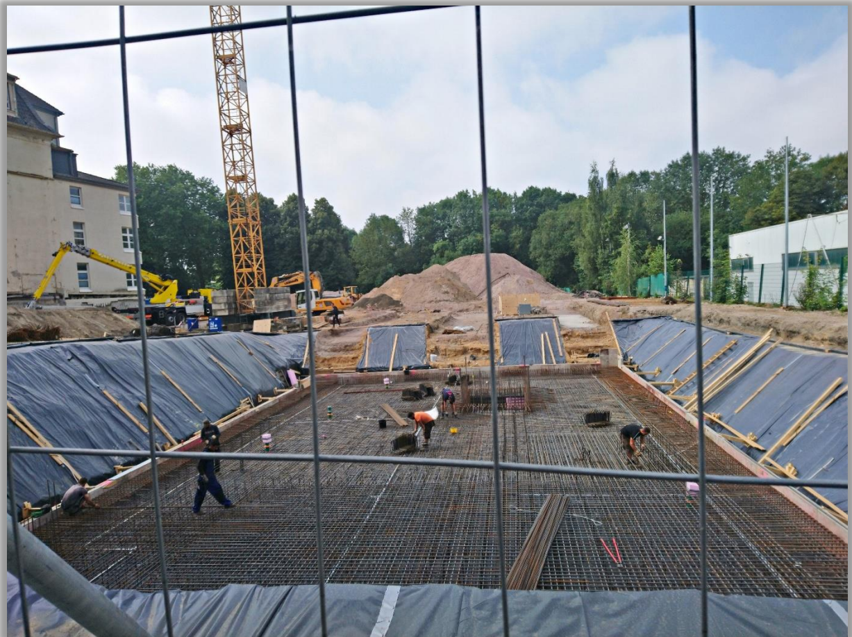
Abbildung 7 Bodenaushub in gewachsenem Lößlehm-Boden für die Errichtung der Pflegeschule auf dem Gelände des St. Maria-Hilf-Krankenhauses in Bochum-Gerthe im Juli 2022 ( Foto Kohlengräberland)
